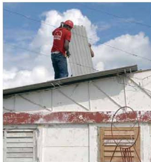
I danni ai tetti sono stati enormi
